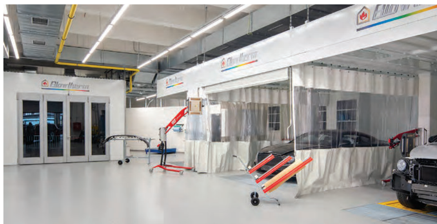
1 Lakovací kabina Blowtherm Extra, vpravo jsou tři přípravná pracoviště Blowtherm, vybavená bočními zástěhami a předními roletami.
